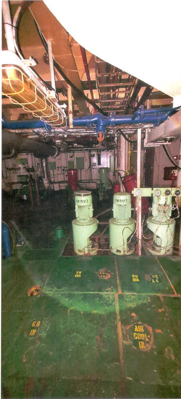
الصورة 23: مضخات تبريد مياه البحر للمحرك الرئيسي
