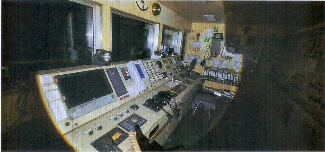
الصورة 20: غرفة التحكم في غرفة الماكينات
