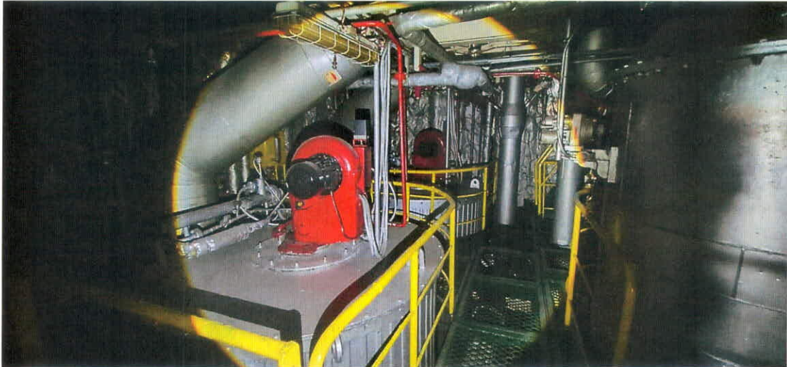
الصورة 33: غلاية الزيت الحراري
