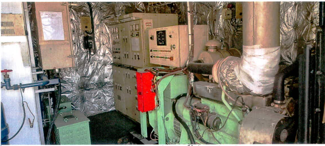
الصورة 27: غرفة مولد الطوارئ بقدرة 60 كيلوات
