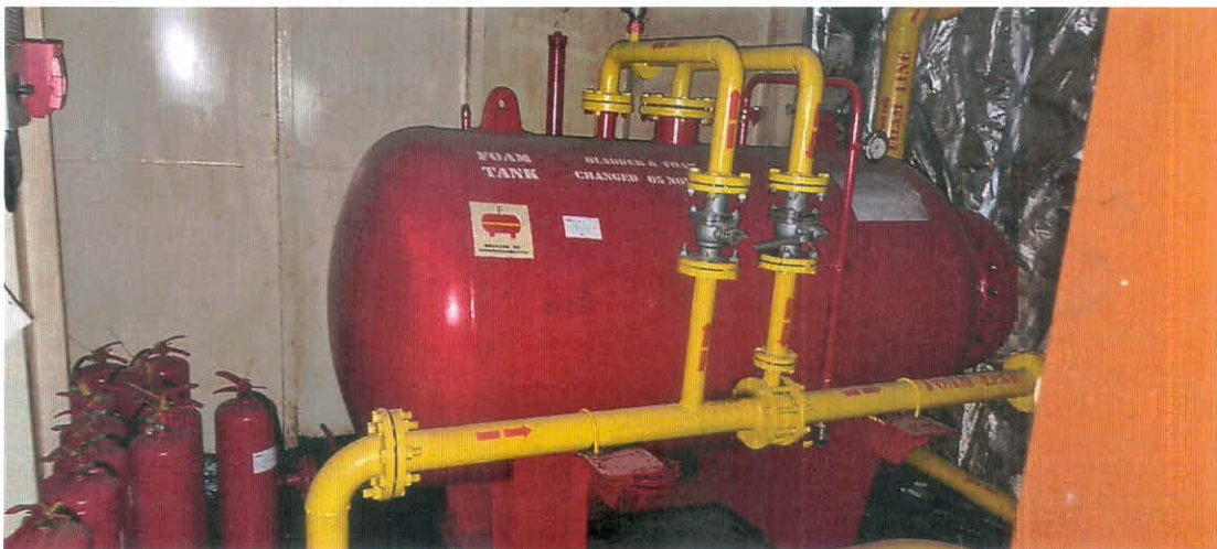
الصورة 38: خزان رغوة إطفاء الحريق
