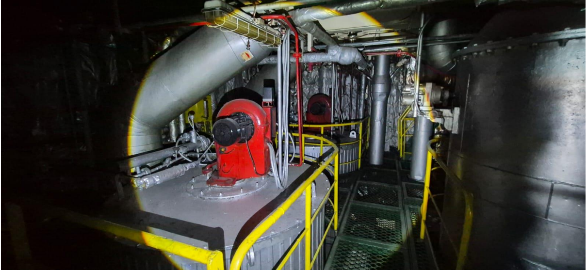
الصورة 33: غلاية الزيت الحراري
