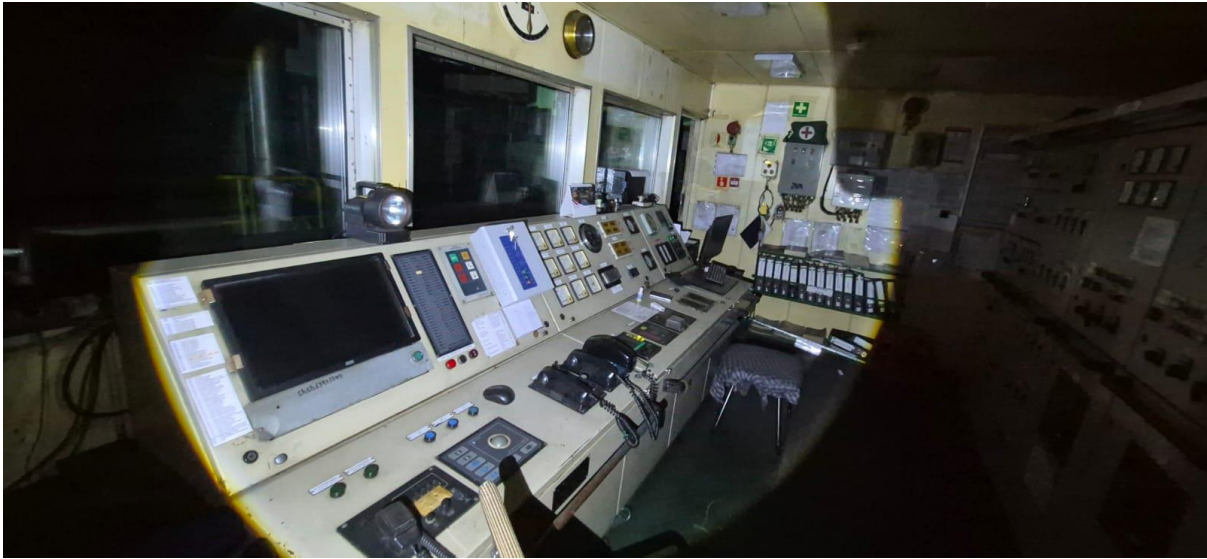
الصورة 20: غرفة التحكم في غرفة الماكينات
