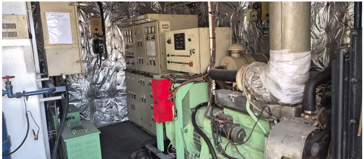
الصورة 27: غرفة مولد الطوارئ بقوة 60 كيلوات
