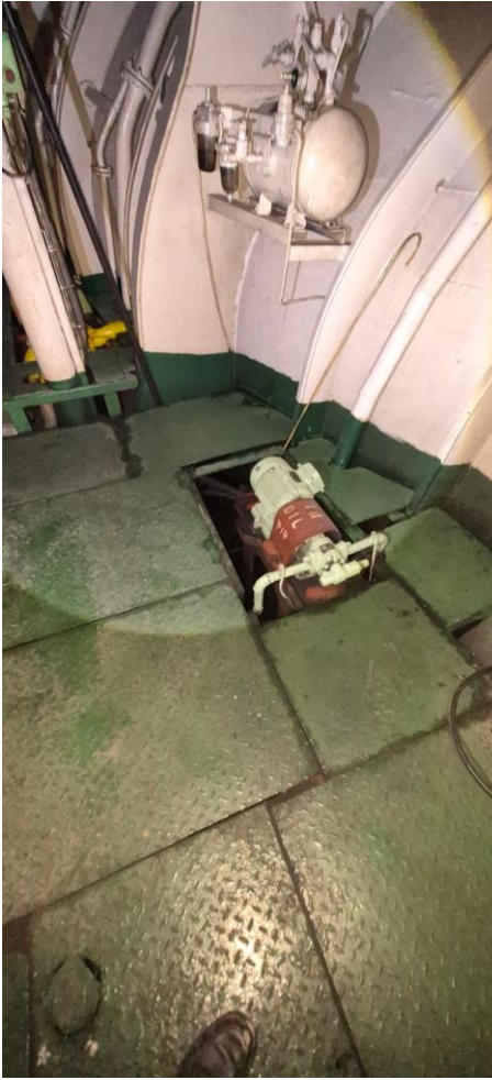
الصورة 28: مضخة نقل الديزل
