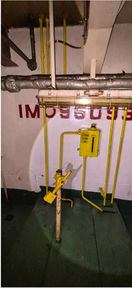
الصورة 29: خزان مانع التسرب لأنبوب المؤخرة
