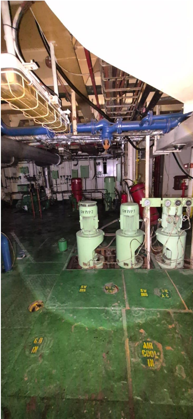
الصورة 23: مضخات تبريد مياه البحر للمحرك الرئيسي
