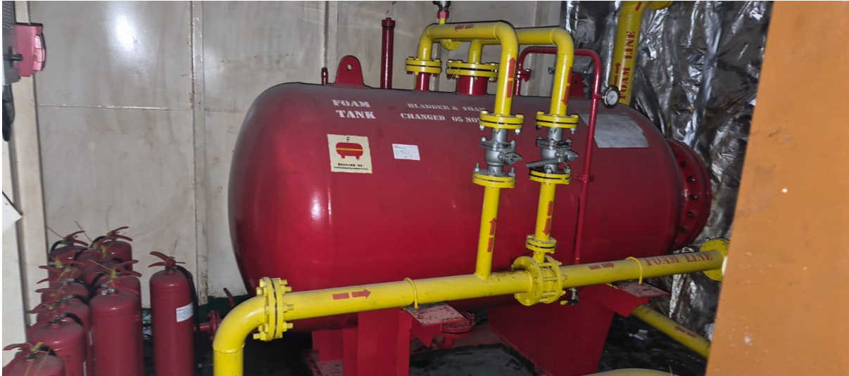
الصورة 38: خزان رغوة إطفاء الحريق
