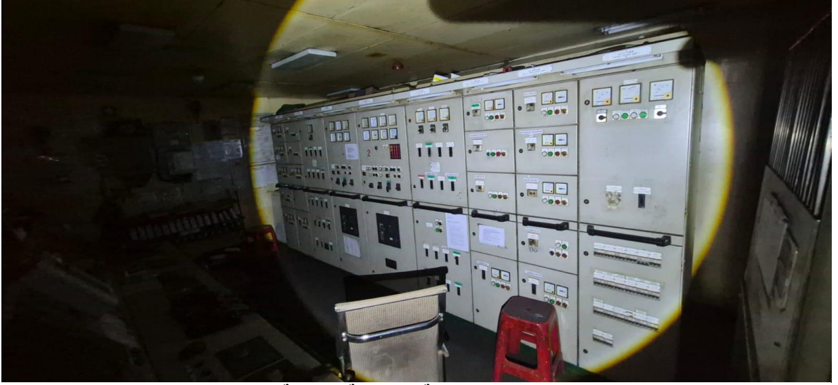
الصورة 32: اللوحة الكهربائية الرئيسية
